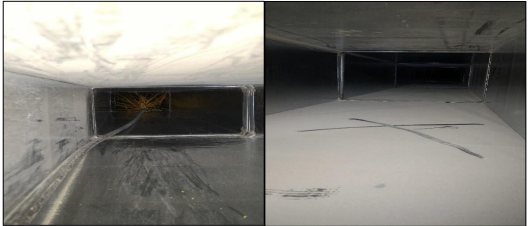
Şekil 10.4. Uygulama esnasında inşai atıklara maruz kalmış havalandırma kanalları
